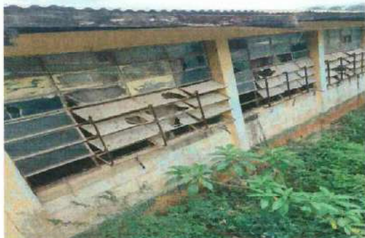
Foto 1: Se observa deterioro en las vigas de madera, se necesita que se cambie.
