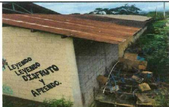
Foto 3: Se observa deterioro de las láminas de la bodega del Centro Educativo.
