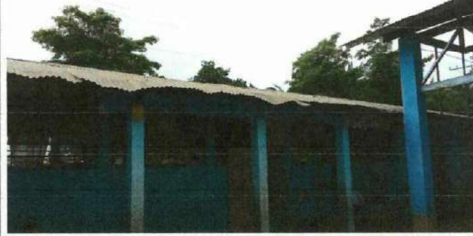
Foto 2: Se observan daños en las láminas del techo en el módulo educativo.
