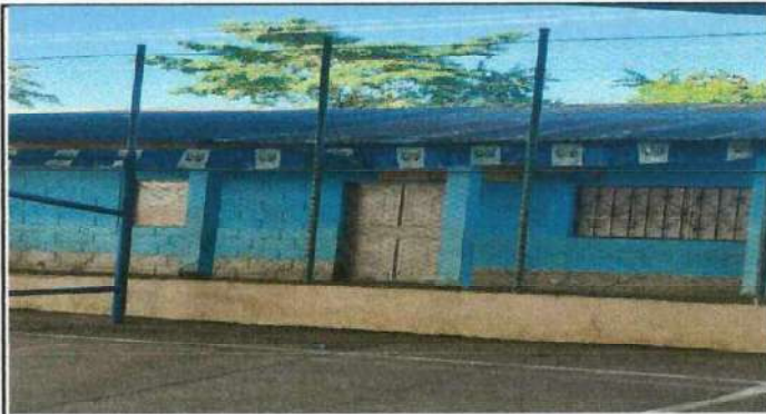
Foto 4: se observa deterioro de las láminas de las aulas.
